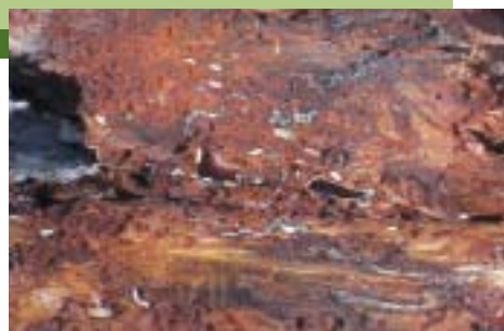
FOTO 17: Efectes del fong emblavador de la fusta
