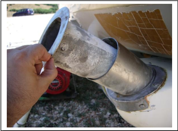
15.15 Filtre a la toma del depòsit de producte
