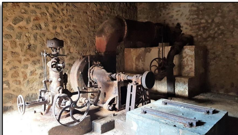
Turbines de la central hidroelèctrica
