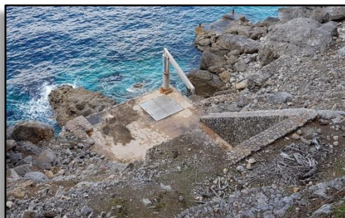
Detall de les instal·lacions de la conducció submarina.
