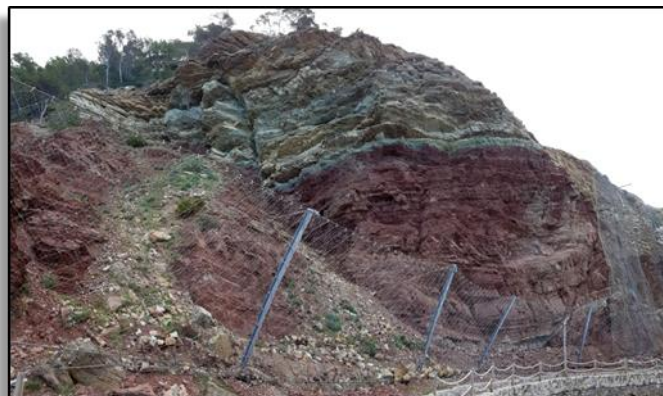
Detall de les mesures de protecció (a primera línia, la pantalla dinàmica i al fons, a la dreta, malla de triple torsió).
