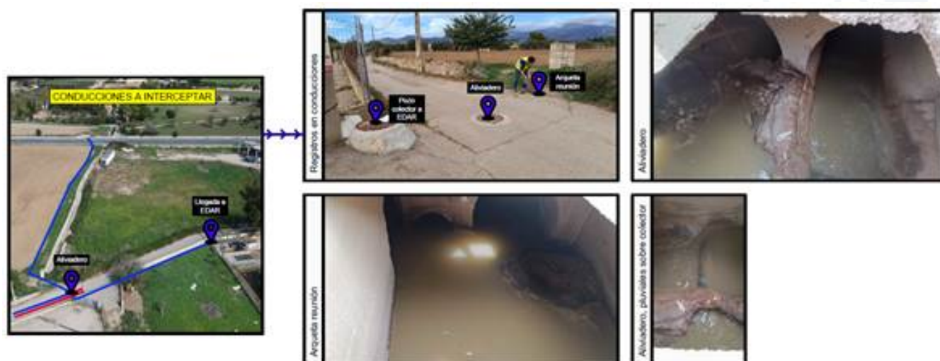
Figura 17. Estado actual de los colectores de entrada. Las aguas pluviales se mezclan con las residuales y, además, hay desvíos de aguas sin depurar a torrente antes de llegar a la EDAR.
