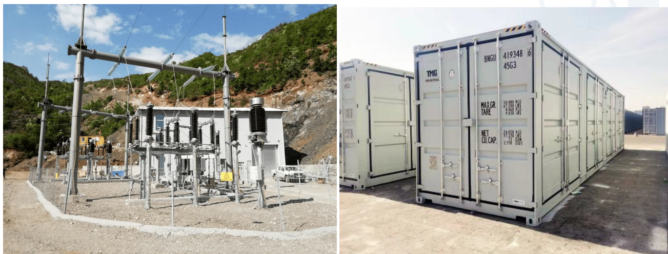
Figura 2. Ejemplo de subestación eléctrica y ejemplo de contenedor de baterías. Fuente: EIA.
