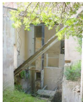
Canaleta de alimentación
