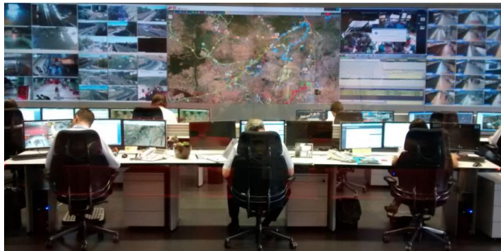
Figura 34. Centro de control operado con SAE (Madrid)
